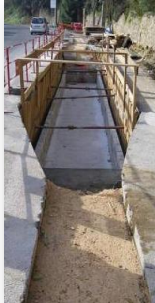
Chambre de jonction
