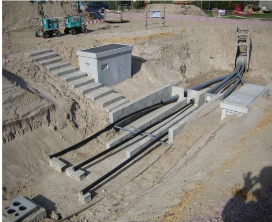
Chambre d'atterrage 16m x 3m x 1m enterrée
