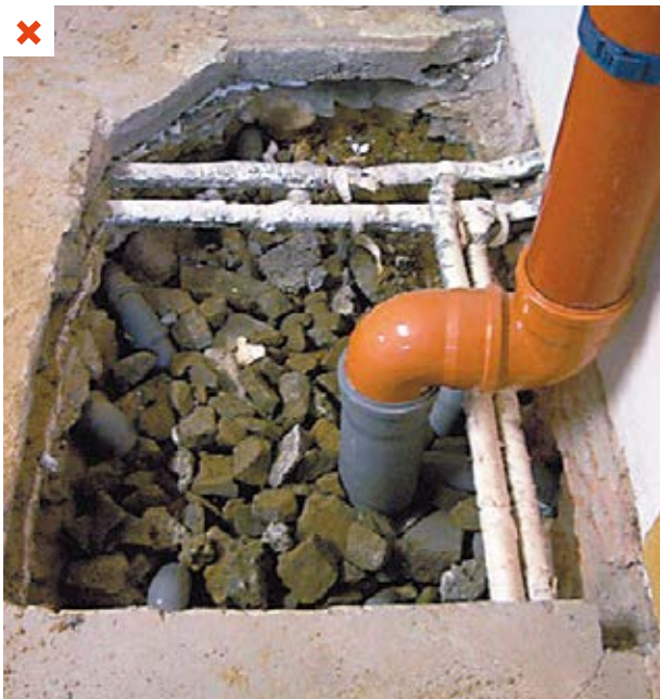
1. Mauvaise pratique : le passage de la conduite à travers la dalle n'est pas étanche. ©OFSP
