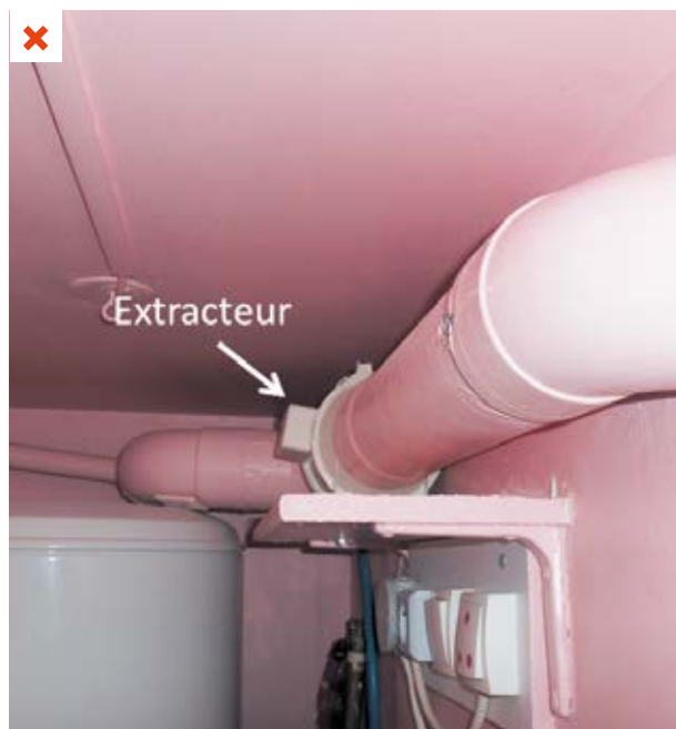
L'extracteur aurait dû être positionné à l'extérieur des locaux ou dans les combles. ©AQC-2015
