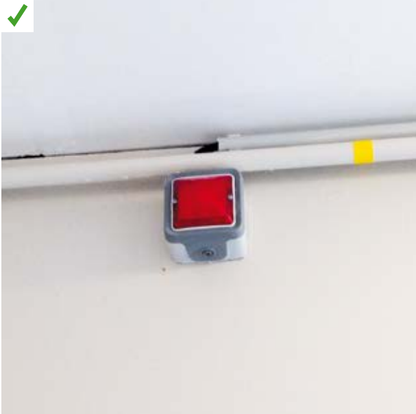
Un témoin lumineux permet d'alerter les occupants d'un dysfonctionnement de l'extracteur. ©AQC
