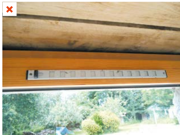
1. L'absence, la fermeture ou le mauvais dimensionnement des bouches d'entrée d'air frais peut-être responsable de l'accumulation de radon. ©AQC-2015
