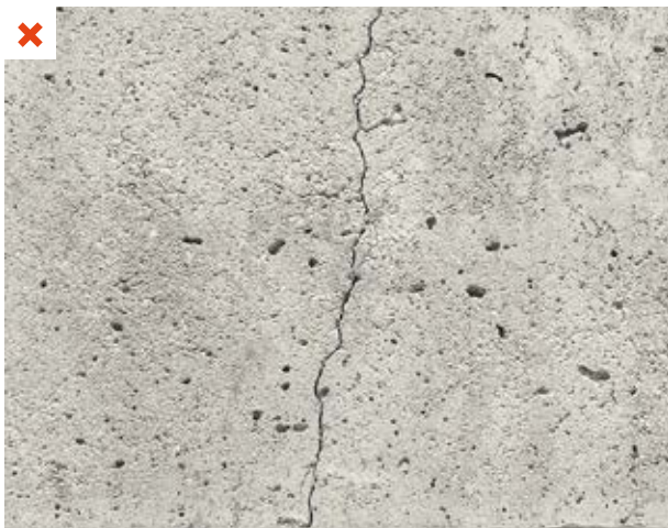
Pores et fissures par lesquelles le radon peut pénétrer dans le bâtiment.
